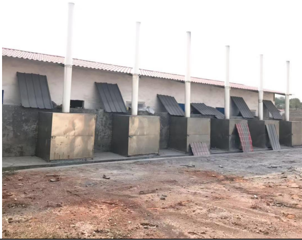
废气处理设施
