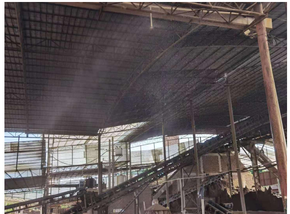
洒水喷淋装置
