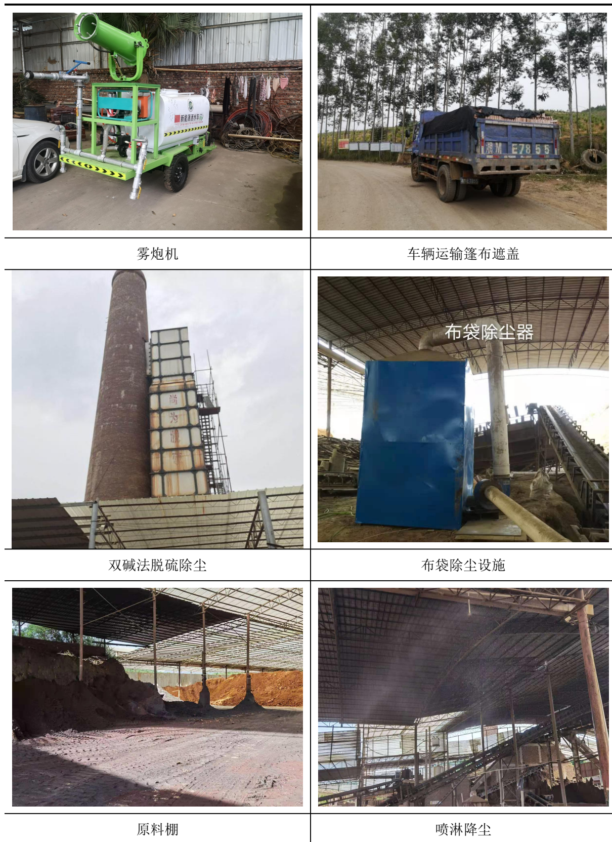
图 4-2 废气处理设施照片
