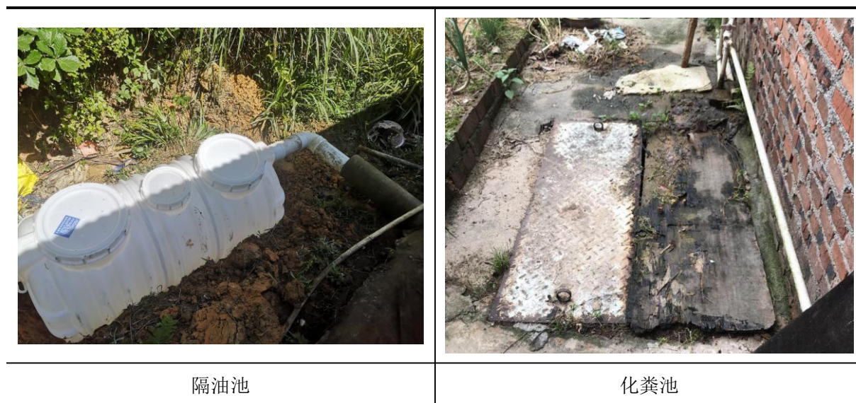
图 4-1 废水处理设施照片
