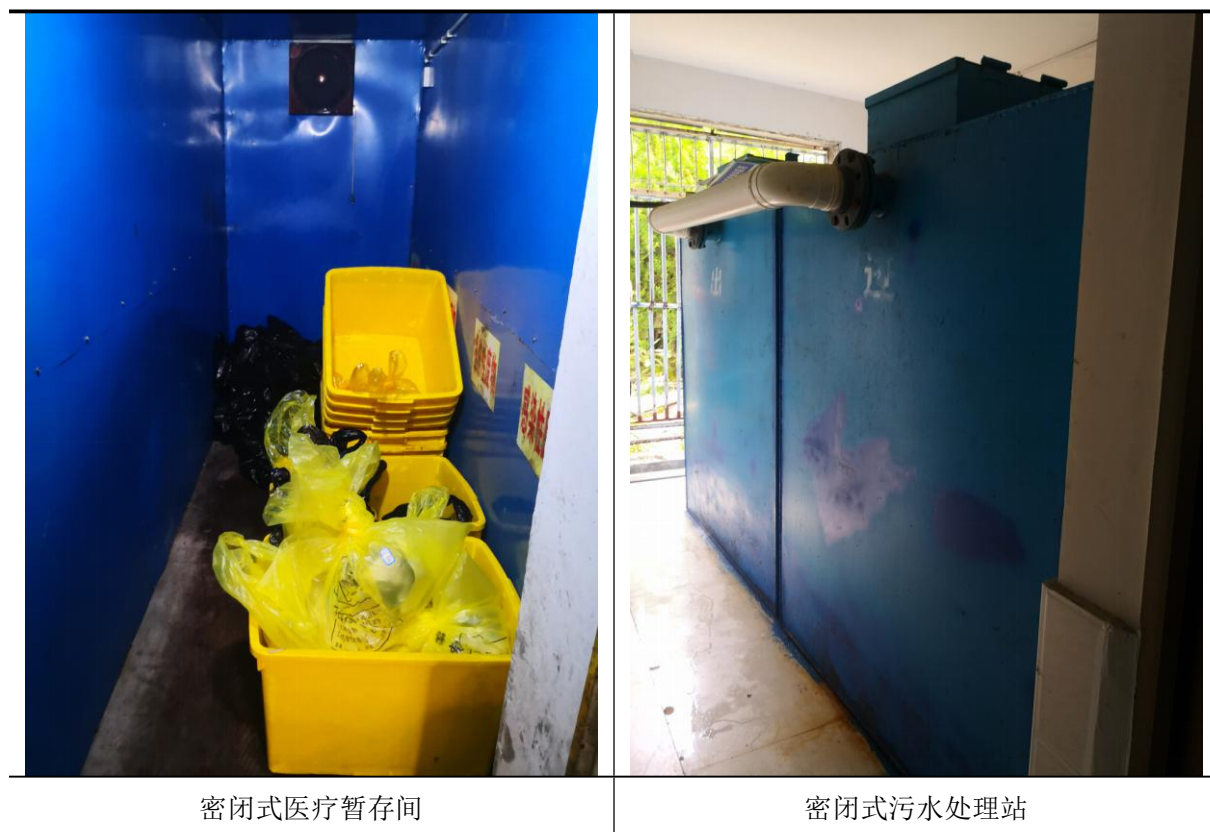
图 4-2 废气处理设施照片
