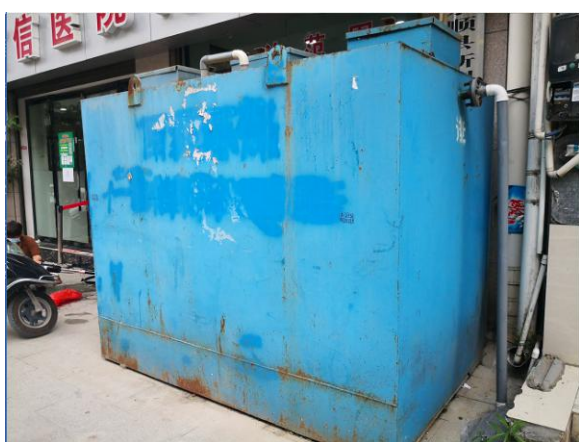
污水处理设施照片
