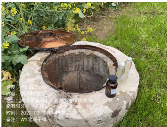
北洲子镇糖厂污水处理站进口采样照片
