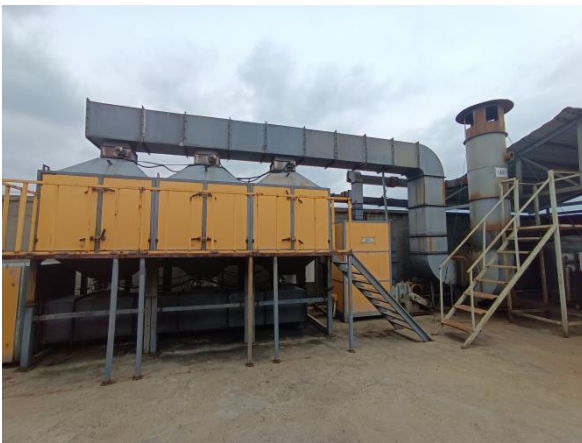
废气处理设施
