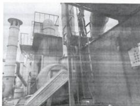
A 4 ④12 栋喷锡废气出口废气采样
