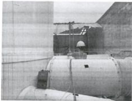
A 3 ③12 栋喷锡废气进口 3 废气采样
