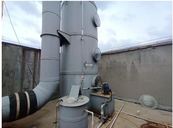
废气处理设施
