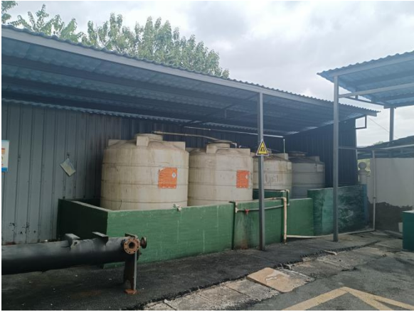
废液储罐及子液储罐
