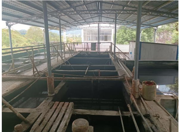
废水处理设施
