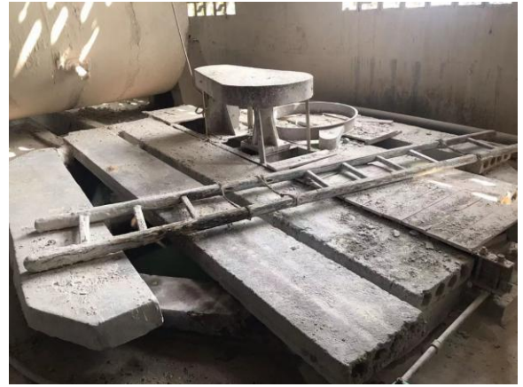
制釉废水沉淀池
