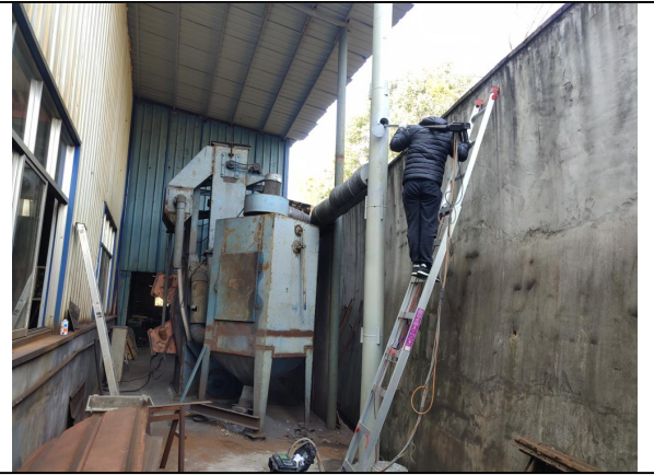
废气处理设施出口采样照片
